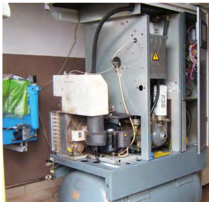
Vecchia macchina ossigeno da sostituire
